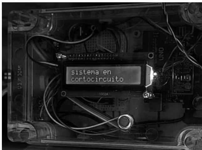
Fig. 13. Cortocircuito en el panel solar.
