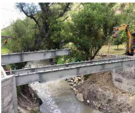
Fig. 20. Montaje de vigas de acero sobre los estribos, mediante retroexcavadora y guía.
