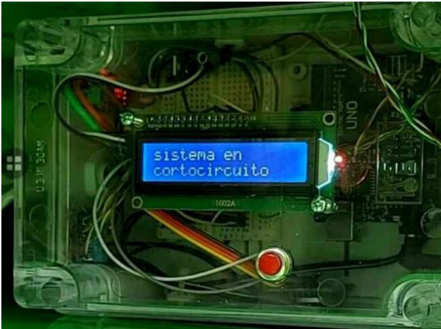
Fig. 13. Cortocircuito en el panel solar.
